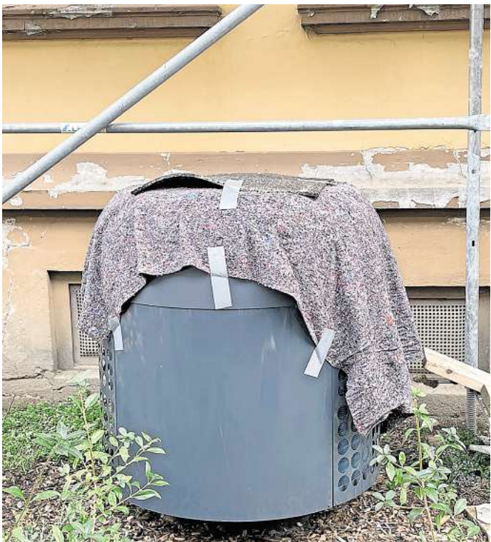
Die unscheinbare Wärmepumpe, die wegen der aktuellen Arbeiten an den Fenstern im Obergeschoss abgedeckt ist, wurde von einer dänischen Firma eingebaut.
