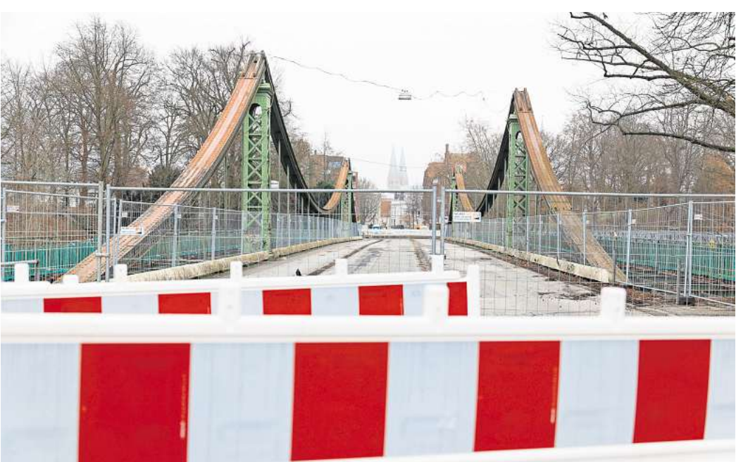
Die Mühlentorbrücke ist wegen Baufälligkeit seit Dezember 2025 gesperrt. Das Bauwerk von 1898 steht unter Denkmalschutz und soll saniert werden. Foto: Lutz Roeßler
