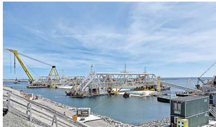
Das zweite Tunnelement, das vor Dänemark abgesenkt werden soll, wird von den Spezialschiffen „Ivy1“ und „Ivy2“ gehalten. Sobald die Wetterbedingungen stimmen, kann es losgehen. Foto: Manuel Büchner
