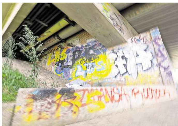
Schmierereien unter der Moltkebrücke: Dort wird dreimal jährlich kontrolliert. Foto: 54° / Felix Koenig
