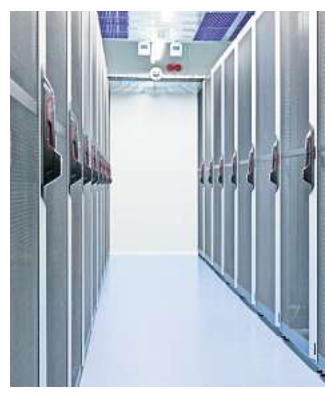
Die Stadtwerke haben im März ihr erstes Rechenzentrum in der Hansestadt eröffnet.
