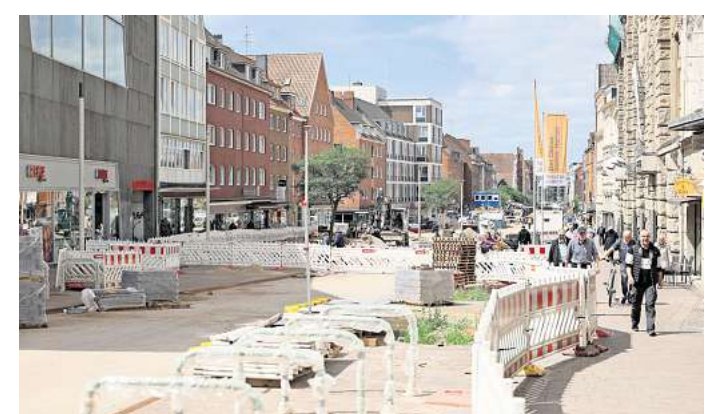
Der obere Teil der Beckergrube wird aktuell aufgehübscht. Im November sollen die Arbeiten beendet sein.
