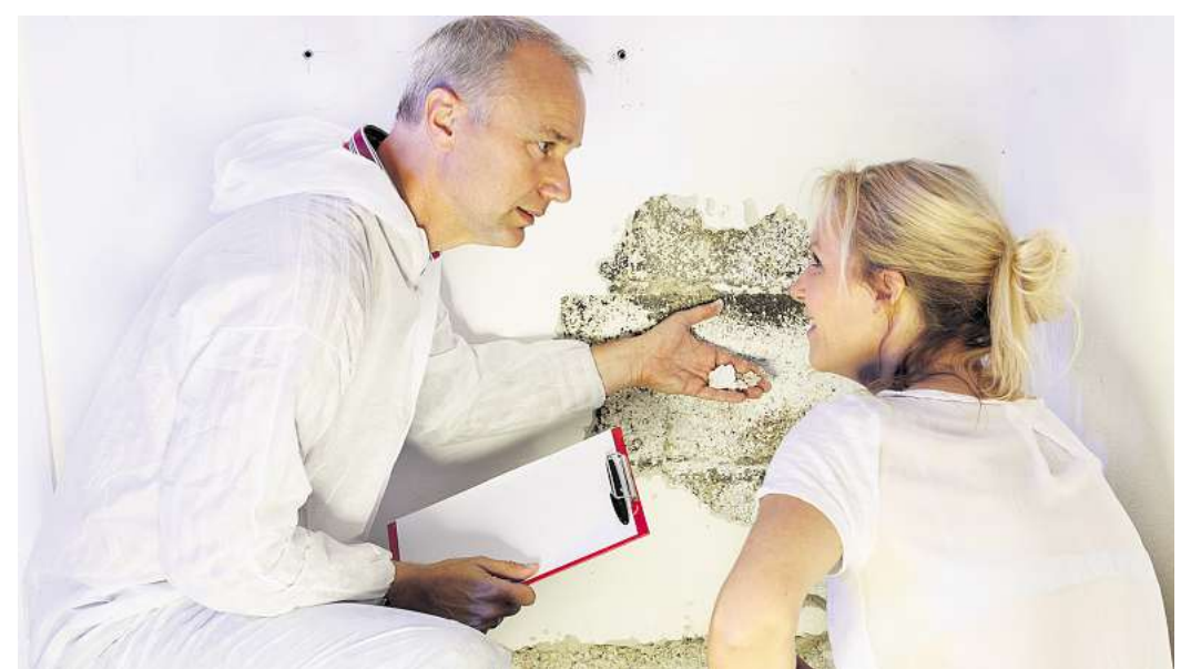
Fachleute empfehlen, die Ursache feuchter Wände und Schimmelbildung fachlich genau zu bestimmen, bevor Maßnahmen ergriffen werden. Foto: Karin/Uwe Annas, RioPatuca Images/stock.adobe.com
