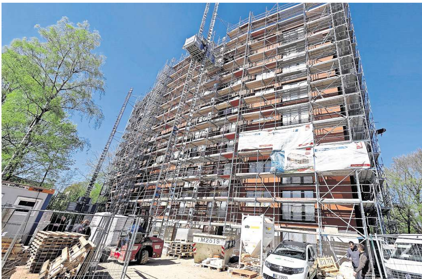
Das neugeschossige Wohngebäude der „Trave“ stammt aus den 1960er-Jahren. Jetzt wird es von Grund auf modernisiert.
