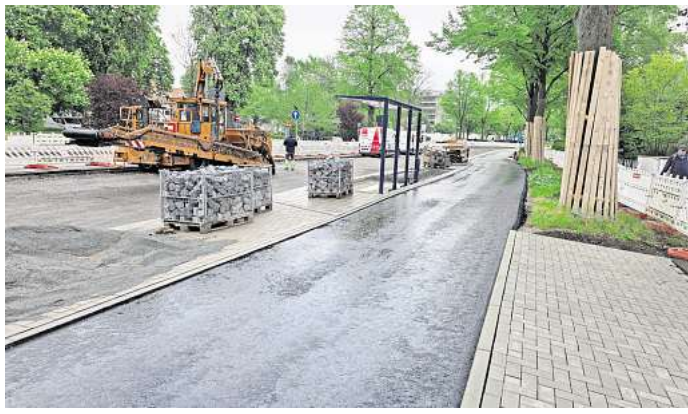
Nahe der Stresemannstraße sind die Arbeiten für den Radschnellweg schon weit fortgeschritten. Foto: Holger Kröger
