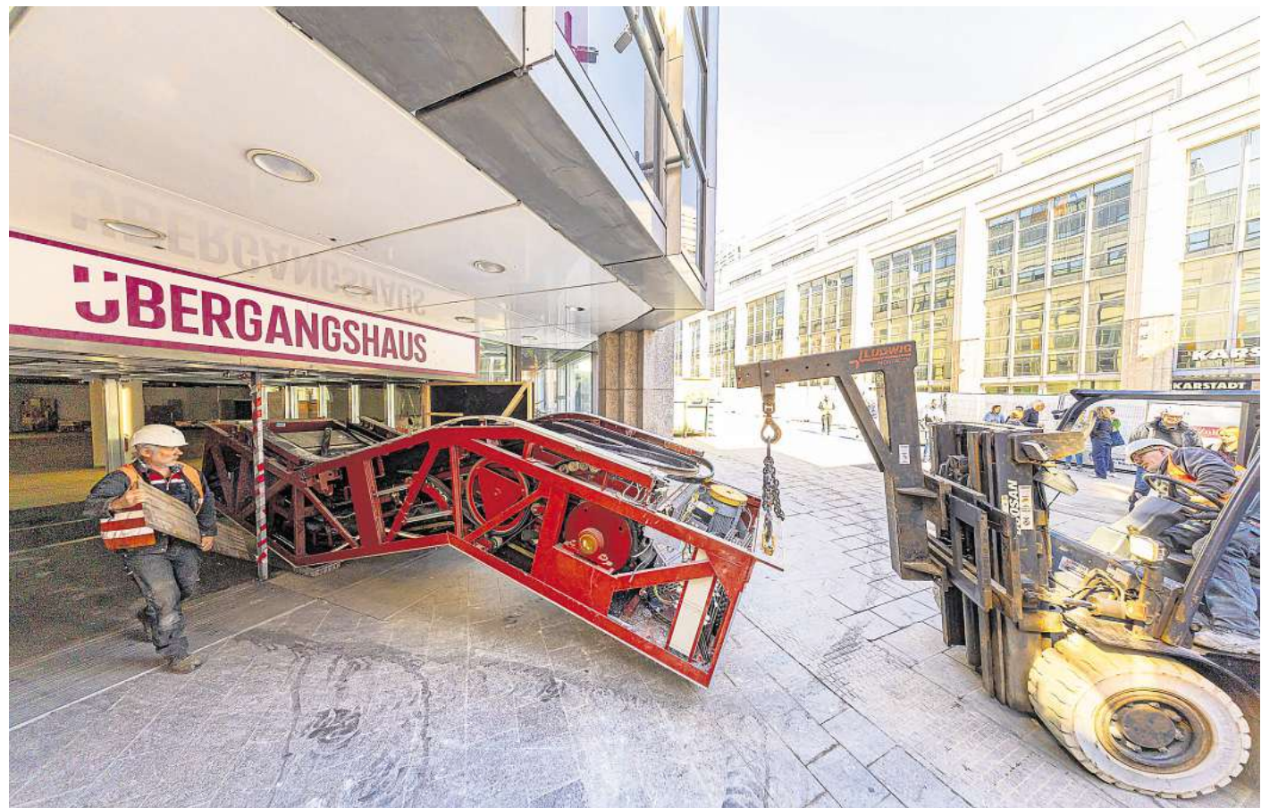
Da ist Präzisionsarbeit gefragt: Die erste Rolltreppe verlässt das frühere Karstadt-Gebäude B durch den Haupteingang. Fotos: Agentur 54°
