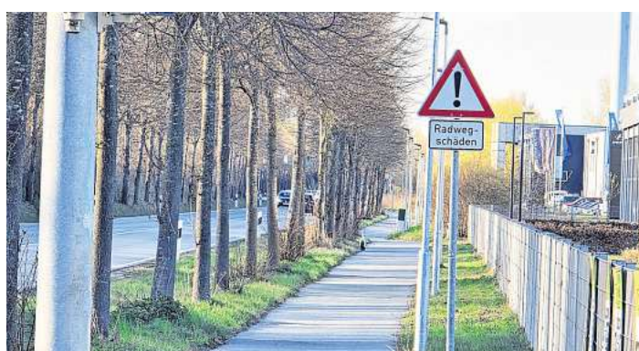
Der Radweg an der B207 zum Hochschulstadtteil soll saniert werden. Baumwurzeln haben die Asphaltdecke beschädigt. Foto: Holger Kröger
