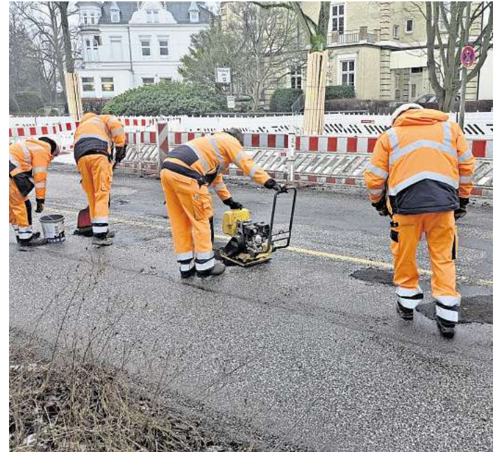
Im Februar hat die Stadt auf der Ratzeburger Allee Schlaglöcher ausgebessert. Bald wird die Fahrbahn erneuert. Foto: Holger Kröger
