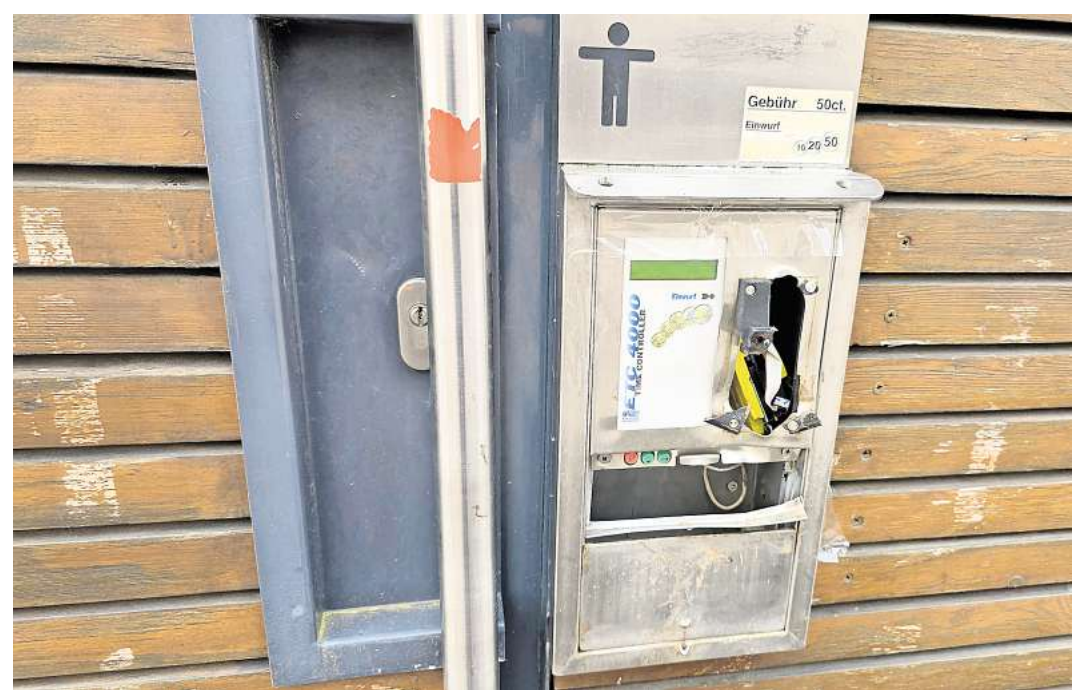
Die WC-Anlage an der Obertrave ist derzeit außer Betrieb.
