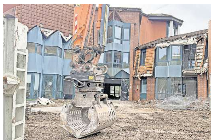
Der Abriss des ehemaligen Pommernzentrums an der Travemünder Ostseestraße begann vor einem halben Jahr. Foto: Thomas Krohn
