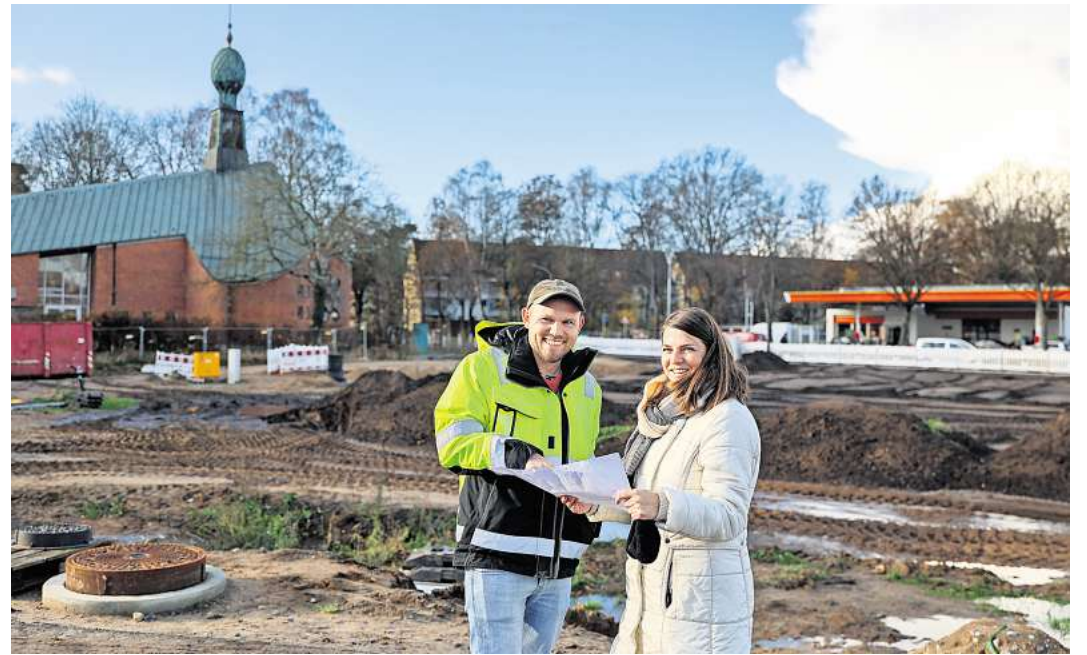
Jan Henningsen von der KWL und Sandra Grunwald von der Stadt Lübeck führen über die Baustelle Lauerhofer Feld. In der Hand haben sie einen Plan und zeigen, wie das Neubauegebiet in Zukunft ungefähr aussehen könnte. Foto: Lutz Roeßler
