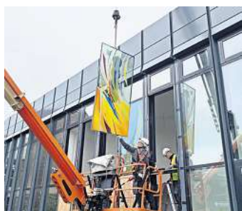
Schritt für Schritt entsteht die neue Fassade: Monteure setzen die Fenster des Raums der Stille im UKSH Lübeck ein. Foto: KKLL
