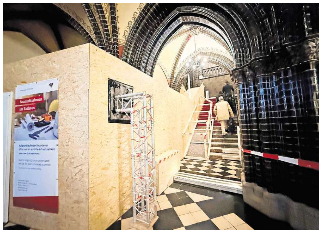
Das Rathaus hat Statik-Probleme, die beseitigt werden. Teile des Foyers und des Treppenhauses sind abgesperrt.
