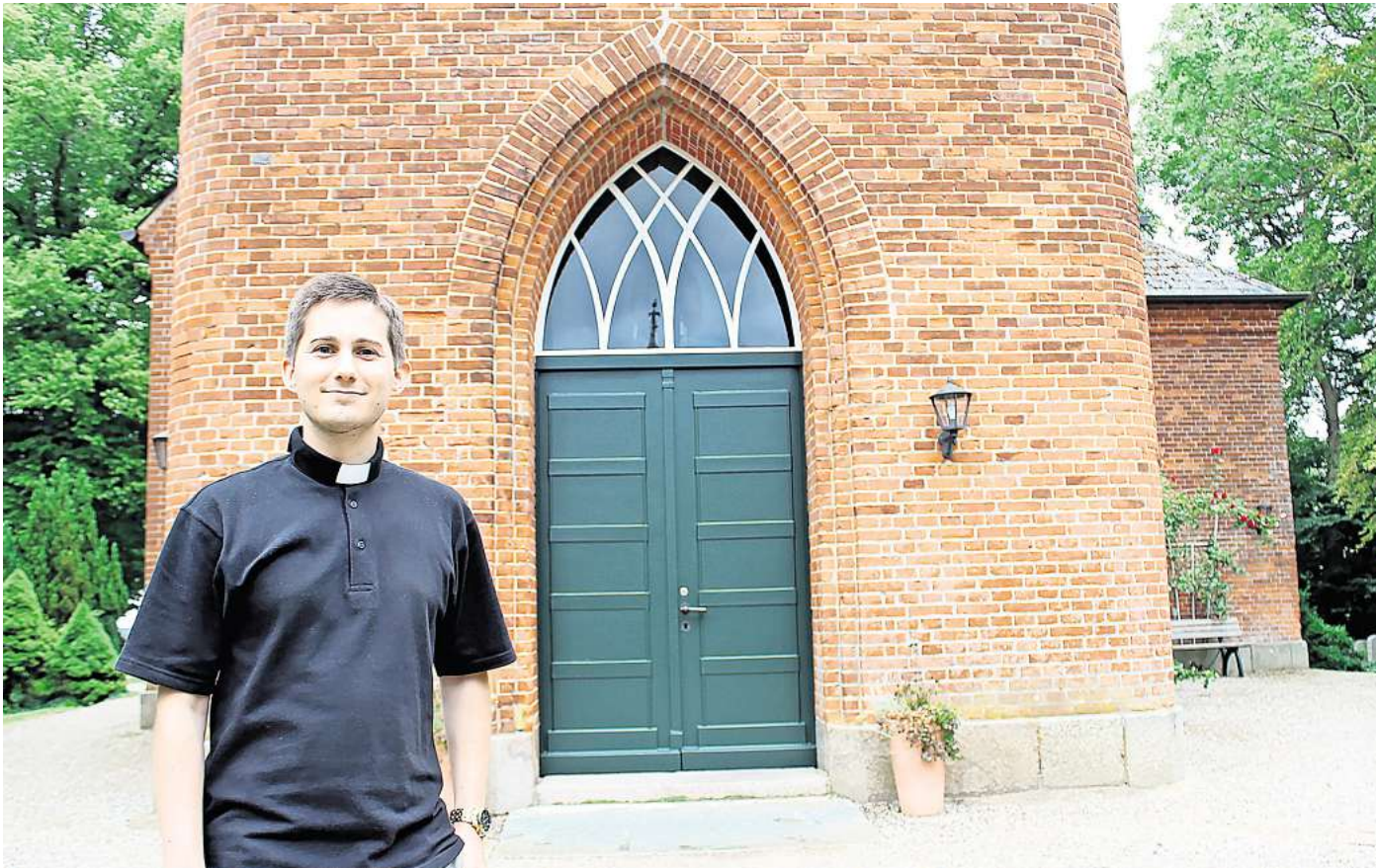
Das Hauptportal strahlt in frischem Grün: Pastor Patrick Pulsfort steht vor dem sanierten Eingang der Hohensteiner Kirche. Das Holz der Tür war stark beschädigt.
