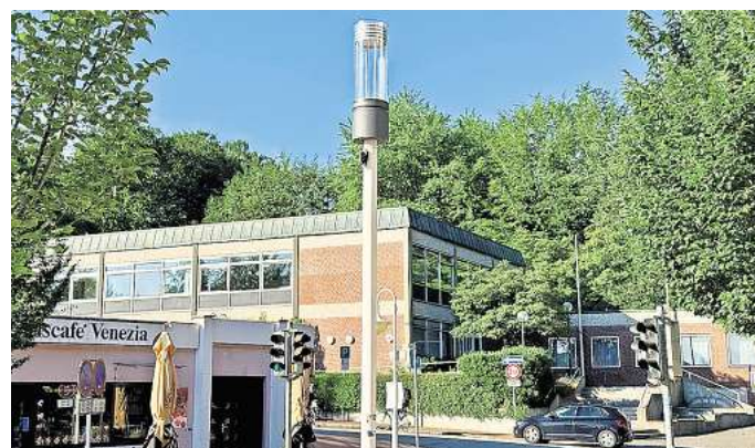
Die schlichte und schnörkellose LED-Mastkopfleuchte „Residenza“ soll die alten Natrium-Dampf-Lampen in der Malenter Bahnhofstraße ersetzen. Fotos: Dirk Schneider
