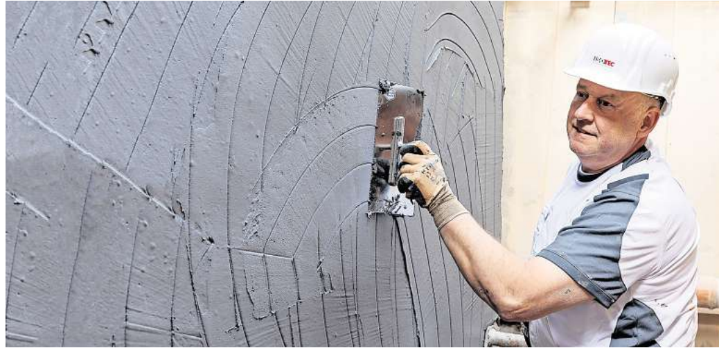
Mit einer professionellen Außenabdichtung bleibt der Keller nicht nur trocken, sondern auch vielseitig nutzbar: als Lagerraum, Homeoffice oder Hobbybereich. Foto: Isotec
