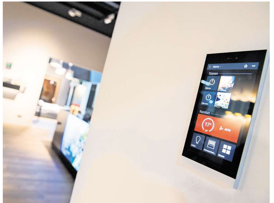
Licht, Temperatur, Rollos: Steht eine Modernisierung der Elektroinstallation an, ist es sinnvoll, Smart-Home-Funktionen gleich mitzudenken. Foto: Franziska Gabbert/dpa
