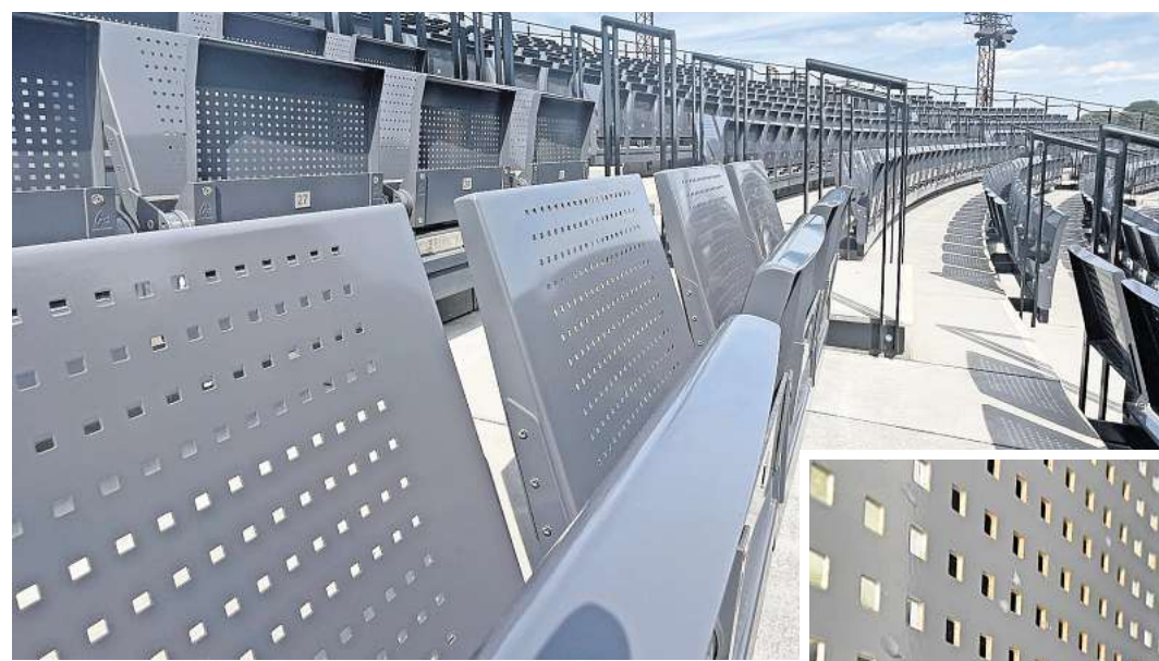
Erst 2024 bekam die Eutiner Seebühne neue Metall-Klappsitze. Noch vor der offiziellen Einweihung im Juni zeigten sich viele Roststellen. Die Lochungen und scharfen Kanten der Stühle sind nicht beschichtet. Rost macht sich breit. Fotos: Ulrike Benthien
