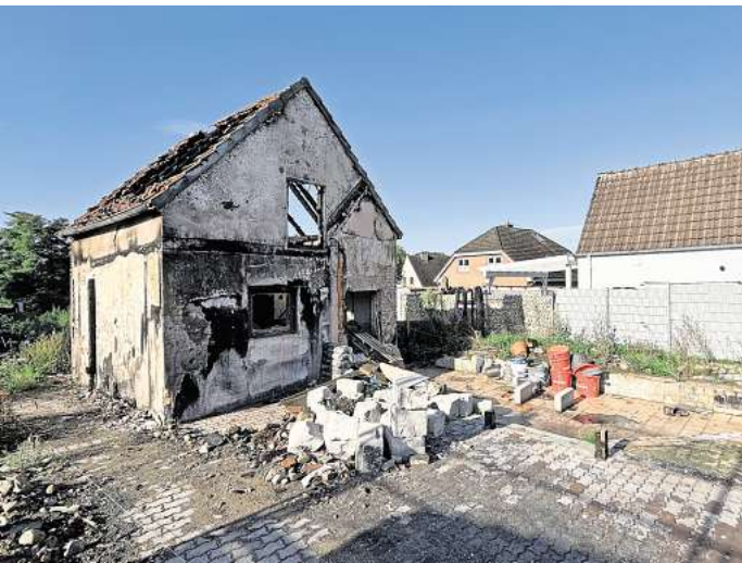
Spuren der Brandnacht sind bis heute zu sehen. Auf dem Nachbargrundstück steht diese Ruine.
