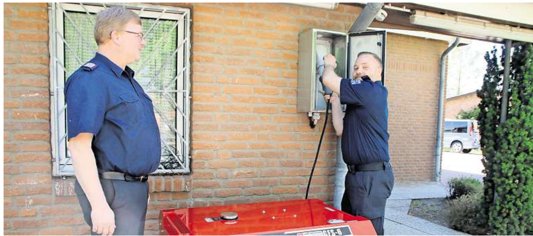
Im Gerätehaus in Eckhorst steht ein Notstromaggregat für Notfälle bereit. Gemeindeführer Lars Schöppich (li.) und Ortswehrführer Christian Paul schließen es an. Wegen der Abgase muss das Gerät draußen stehen.
