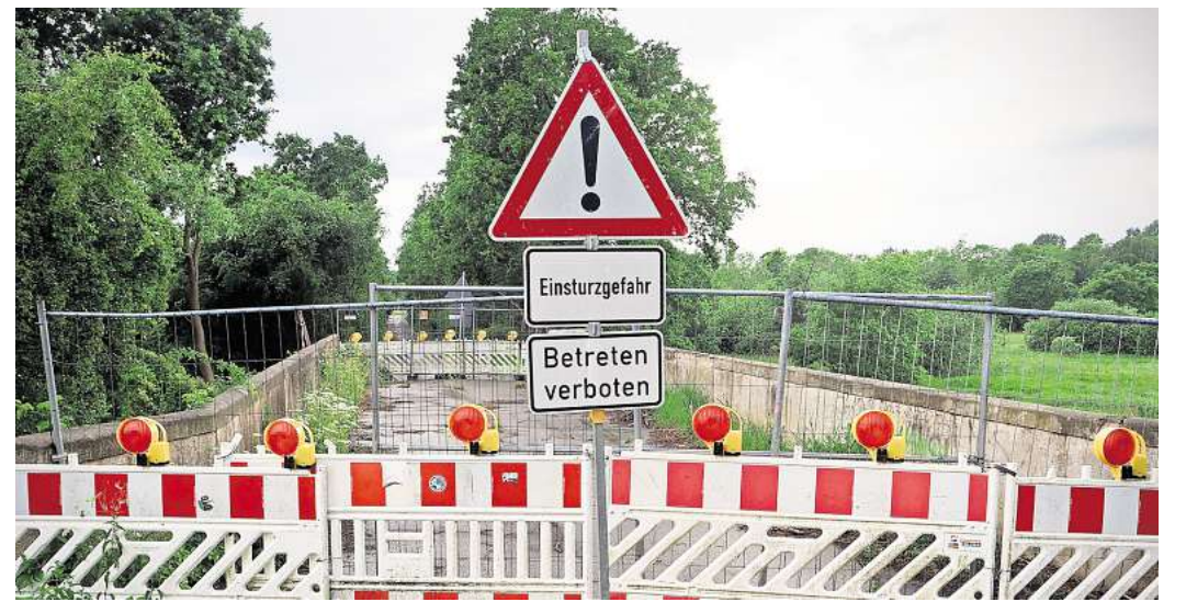
Die Brücke über die Alte Schwartau ist bis heute gesperrt. Vor fast sechs Jahren erlitt ein Radfahrer durch einen Unfall hier schwerste Verletzungen.
