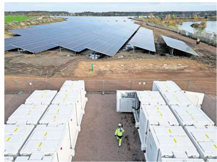
So oder so ähnlich könnte die Batteriespeicheranlage aussehen, die in Schwöchel entstehen soll.
