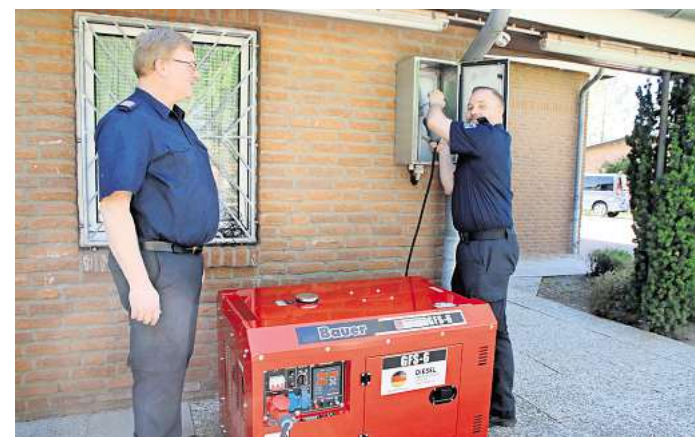
Im Gerätehaus in Eckhorst steht ein Notstromaggregat für Notfälle bereit. Gemeindeführer Lars Schöppich (li.) und Ortswehrführer Christian Paul schließen es an. Wegen der Abgase muss das Gerät draußen stehen.
