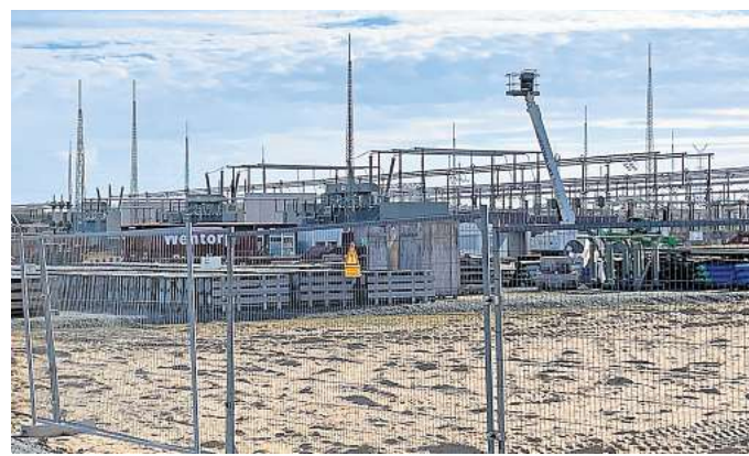
Das Umspannwerk Lübeck-West unweit zur Stockelsdorfer Dorfschaft Pohnsdorf an der L184 wächst und wächst. In 500 Metern Entfernung ist zudem ein Batteriespeicher geplant.
