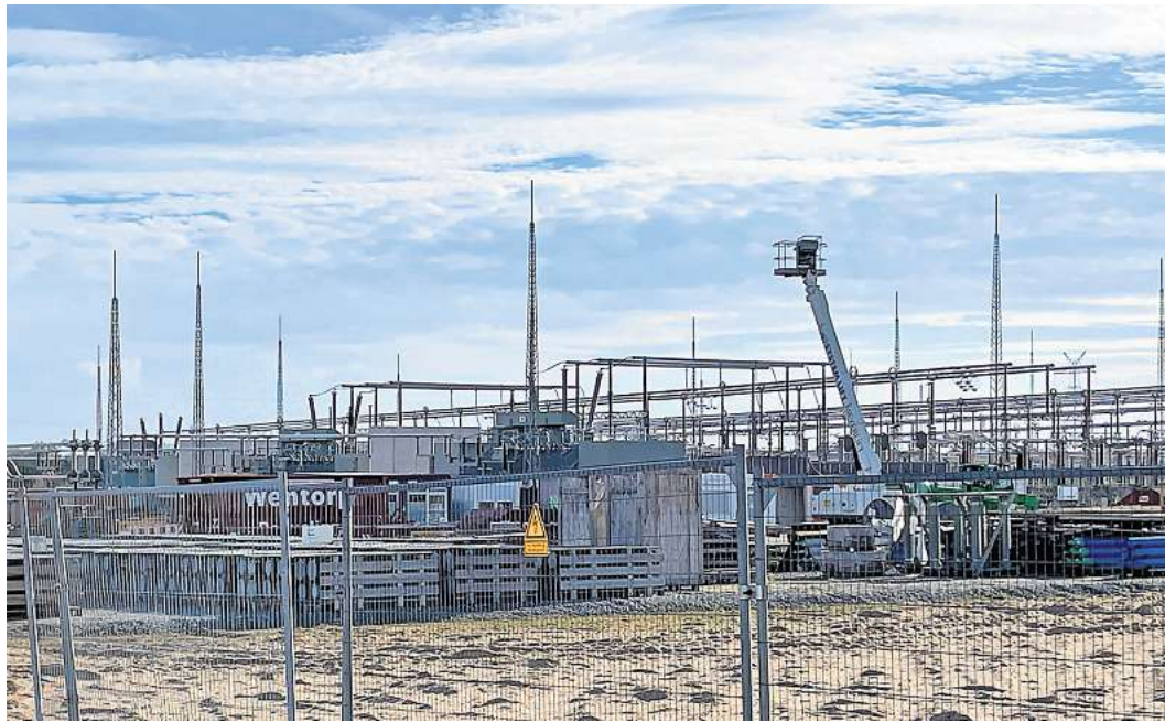
Das Umspannwerk Lübeck-West unweit der Stockelsdorfer Dorfschaft Pohnsdorf an der L184 wächst und wächst. Foto: Sebastian Prey
