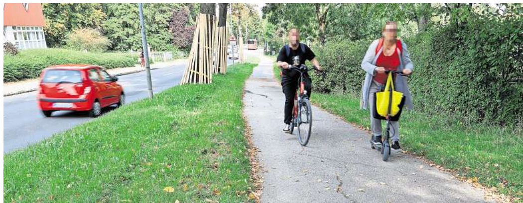
Risse, Buckel, Sandflächen – der Radweg an den Straßen Am Moislinger Baum und Moislinger Berg muss dringend erneuert werden.
