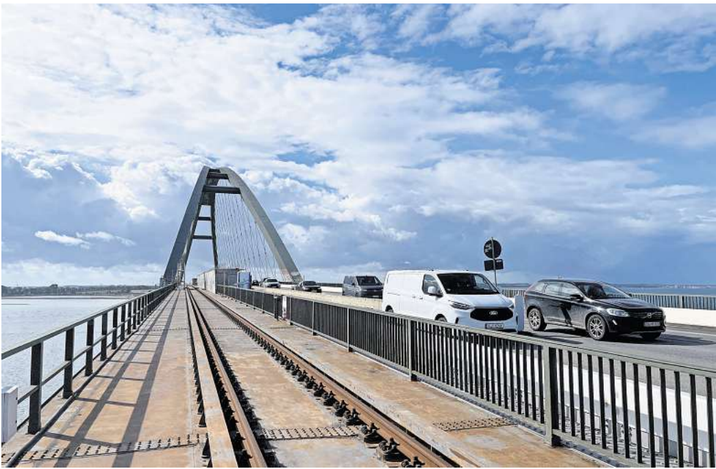
Die Fehmarnsundbrücke wird seit sechs Jahren saniert. Die Arbeiten sollen bis 2030 fertig sein, zuvor hatte es stets 2028 geheißten.
