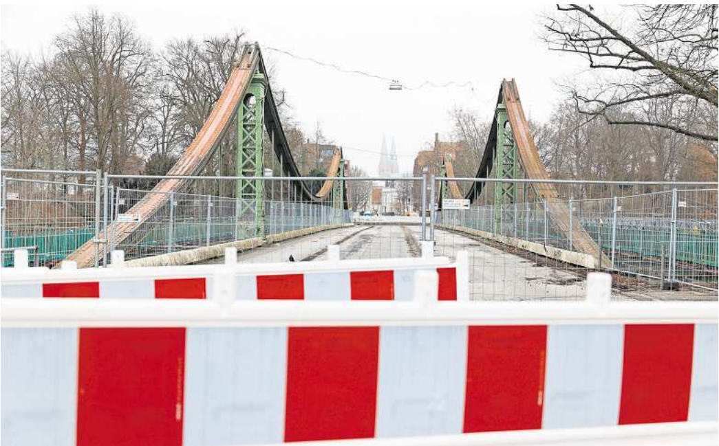
Die Mühlentorbrücke ist wegen Baufälligkeit seit Dezember 2025 gesperrt. Das Bauwerk von 1898 steht unter Denkmalschutz und soll saniert werden. Foto: Lutz Roeßler
