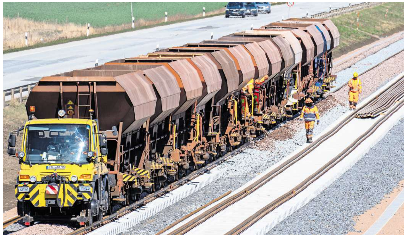
Die Gleise auf Fehmarn werden mit Schotter verfüllt. Die Insel ist bisher der einzige Ort, an dem für die neue Trasse schon gebaut wird. Foto: Deutsche Bahn
