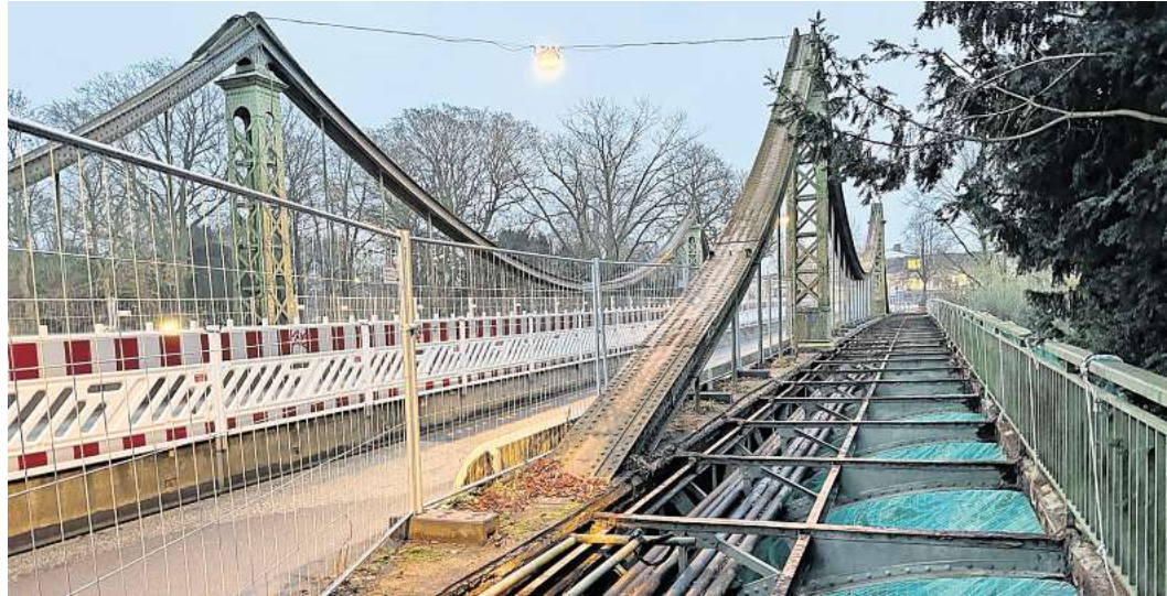
Die Mühlentorbrücke ist gesperrt. Bereits zuvor war auf dem früheren Gehweg der Bodenbelag entfernt worden. Foto: Helge von Schwartz
