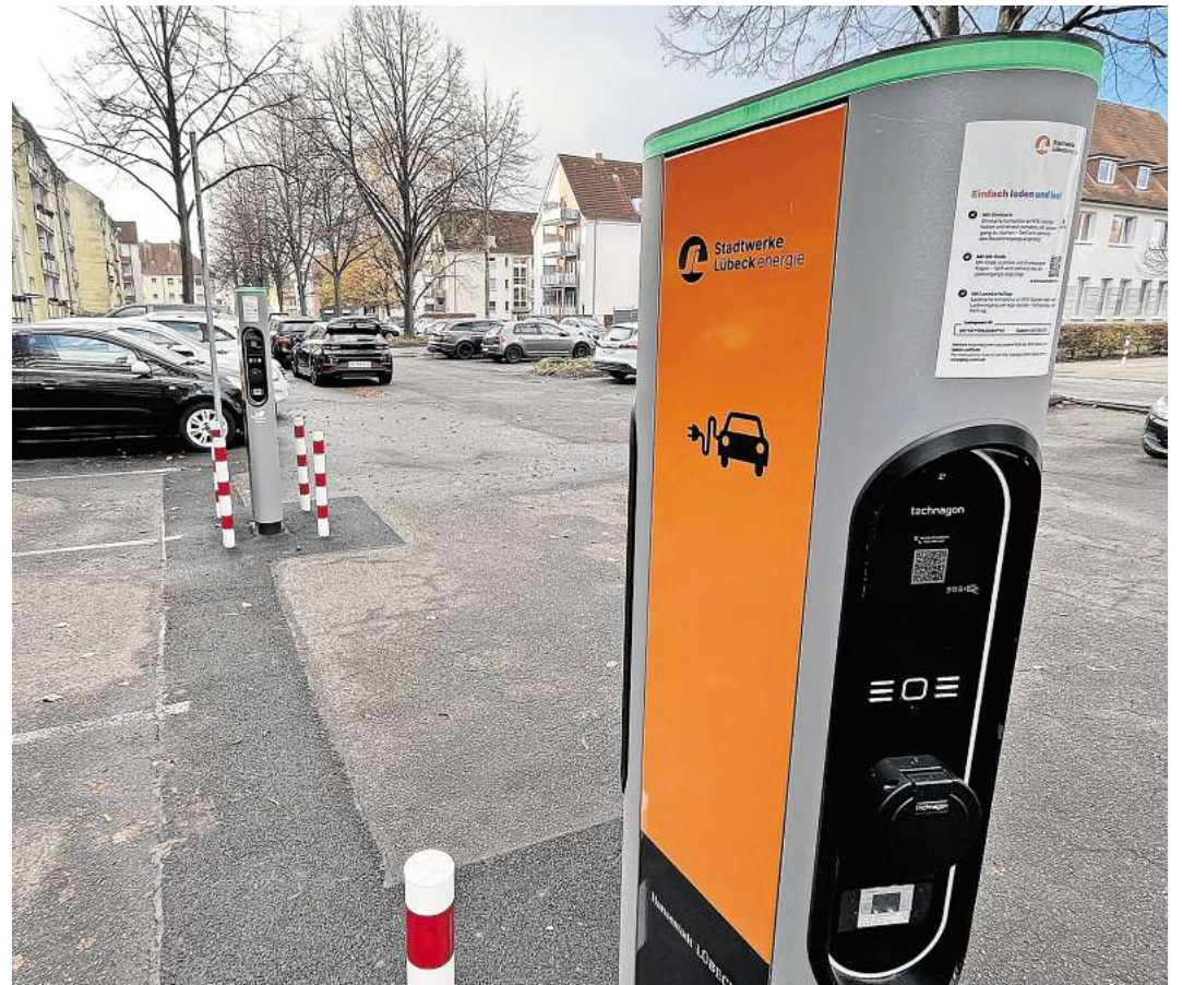
In der Bülowstraße auf Marli stehen zwei E-Ladesäulen der Stadtwerke Lübeck.
