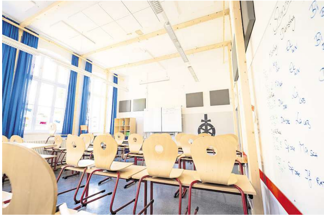
Die Decken in Klassenräumen im Katharineum müssen mit einer Konstruktion abgestützt werden – wie ein Archivfoto aus dem Jahr 2023 zeigt. Foto: Agentur 54°
