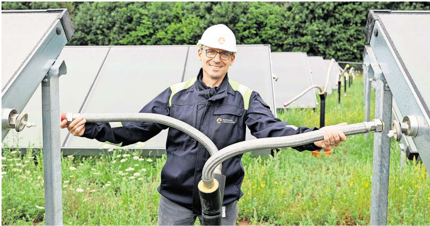
In der Mitte des Kollektorfeldes laufen die Leitungen zusammen, mit denen das heiße Wasser zum Speicher gepumpt wird. Foto: Lutz Roeßler
