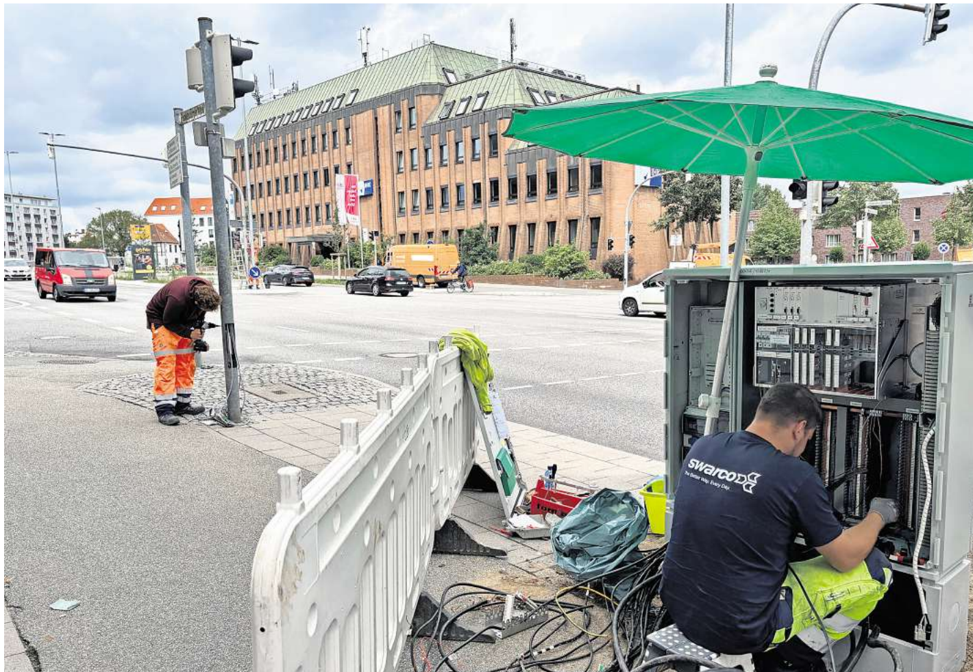
Die Kabel hängen aus einer Ampel an der Kreuzung Fackenburger Allee/Werner-Kock-Straße. Ein Arbeiter verkabelt die Steuerungselemente in einem Sicherungskasten neu: Für einen Tag mussten die Ampeln dort für das Projekt Viaa ausgeschaltet werden. Foto: K. Steinert
