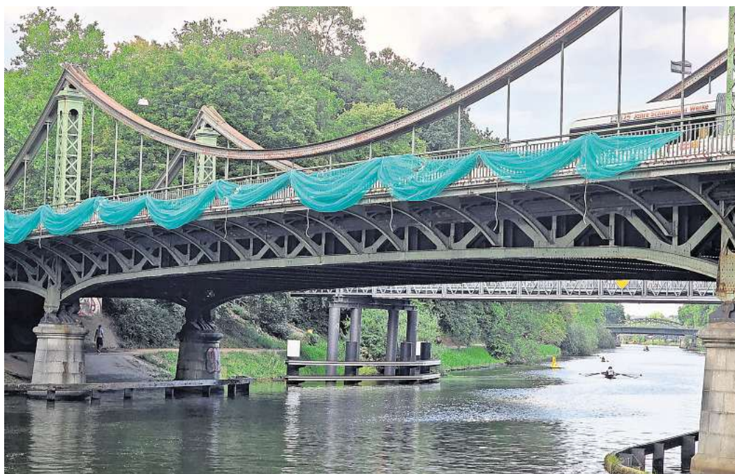
Weil Teile abzaplaten drohen, ist die Mühlentorbrücke derzeit mit Fangnetzen versehen. Demnächst wird die Brücke halbseitig gesperrt.
