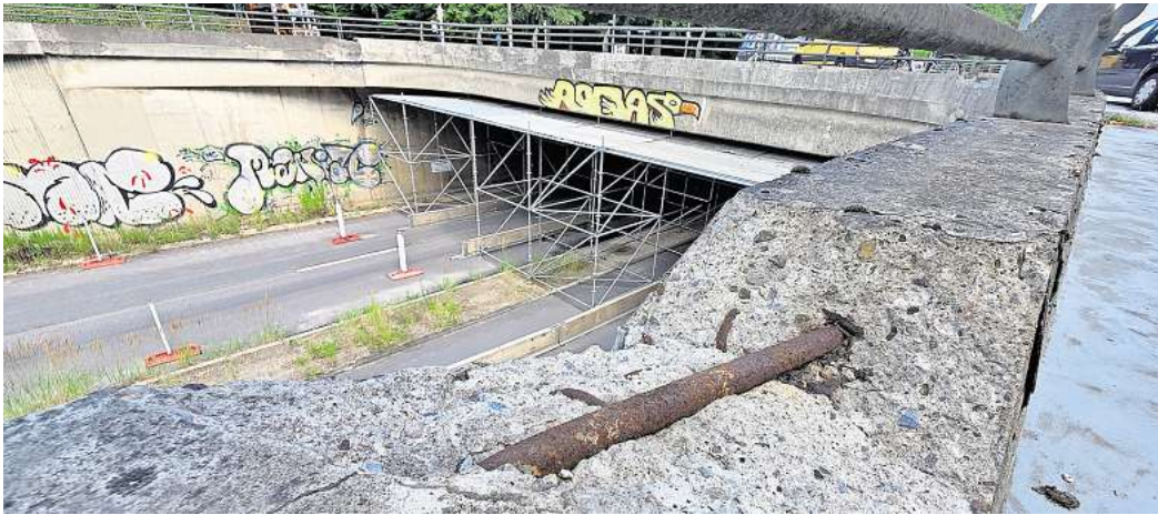
Die Sandbergbrücke wurde 1962 gebaut. Ein Gerüst sichert Fahrzeuge vor herabfallenden Betonteilen. Foto: Holger Kröger
