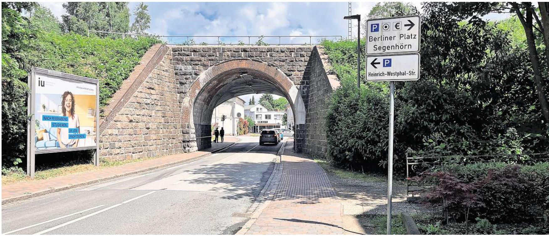
Die Unterführung an der Albert-Mahlstedt-Straße. Der Firma „team red“ zufolge sind die Fußwege unter dem kurzen Tunnel deutlich zu schmal.
