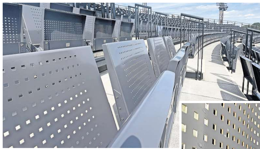
Erst 2024 bekam die Eutiner Seebühne neue Metall-Klappsitze. Noch vor der offiziellen Einweihung im Juni zeigten sich viele Roststellen. Die Lochungen und scharfen Kanten der Stühle sind nicht beschichtet. Rost macht sich breit.
