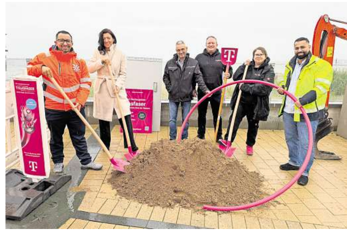
Spatenstich für Glasfaser in Scharbeutz (v.l.): Bauamtsmitarbeiter Paulo Chaves, Bürgermeisterin Bettina Schäfer, Thomas Giessler, Carsten Hartung, Sabrina Ahrens (alle Telekom) und Bauleiterin Dana Jassim.
