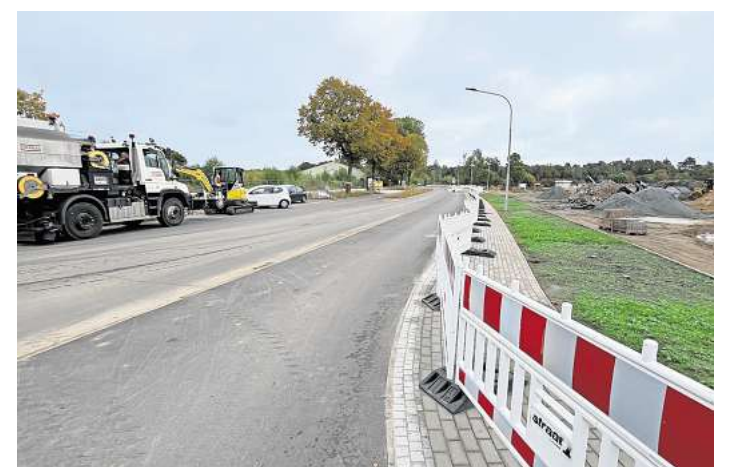
Die letzten Arbeiten laufen: Am 14. Oktober wird die Schlutuper Straße in Lübeck für den Verkehr freigegeben. Foto: Oliver Pries
