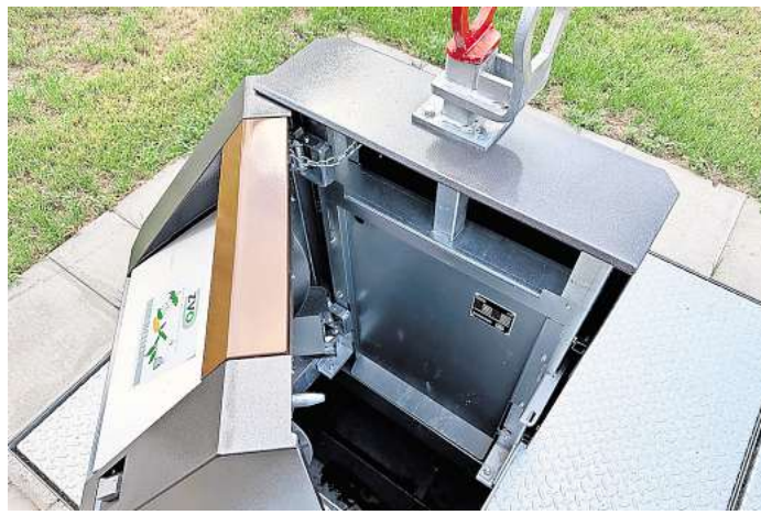
Nach dem Öffnen der Servicetür kann man in den Unterflurbehälter der Müllsammelstelle schauen.
