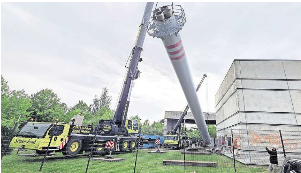
Kräne im Einsatz: Ein 23 Tonnen schwerer Schornstein an der Carl-Gauss-Straße wird aufwendig demontiert.
