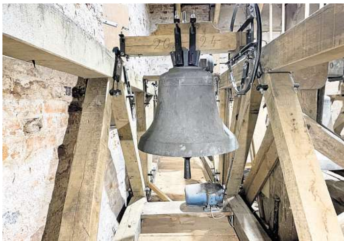
Der neue Glockenstuhl – ein wurmbefallenes Brett setzte hier vor Jahren die Planung zur umfangreichen Sanierung der Kirche in Gang.
