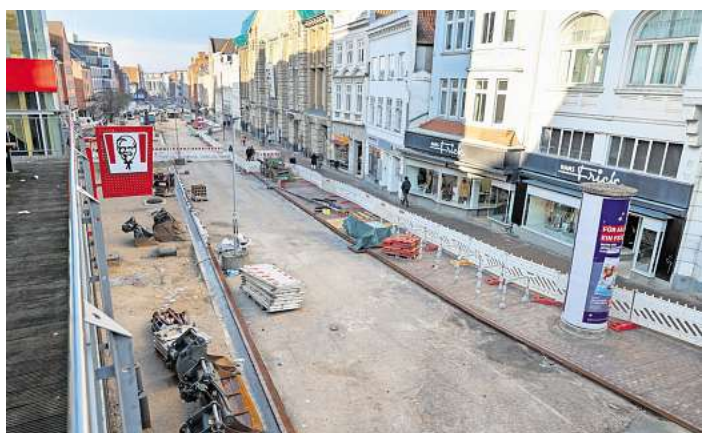
Die Beckergrube wird derzeit von der Breiten Straße bis zur Kreuzung Kupferschmiedestraße/Fünfhauserneuert. Der Bund fördert das Projekt mit 3,5 Millionen Euro. Foto: Lutz Roeßler
