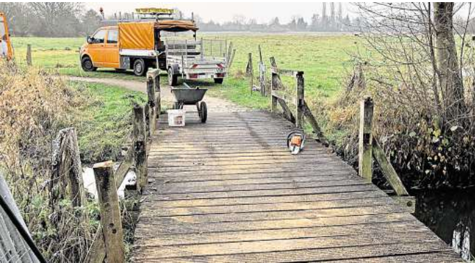
Die Brücke Morier Hof im November 2025: Das Bauwerk galt nicht mehr als verkehrssicher. Foto: Oliver Pries
