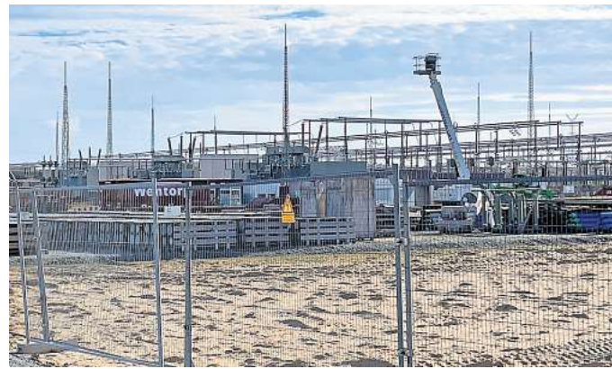
Das Umspannwerk Lübeck-West unweit zur Stockelsdorfer Dorfschaft Pohnsdorf an der L184 wächst und wächst. In 500 Metern Entfernung ist zudem ein Batteriespeicher geplant.
