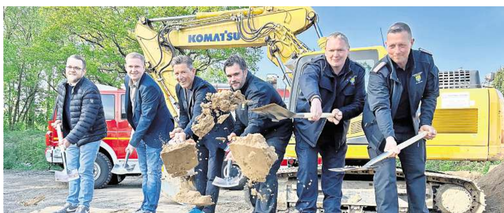
Gute Laune beim ersten Spatenstich in Sereetz hatten Bauleiter Magnus Frahm (v.li.), der Bürgermeister Daniel Thomaschewski, Bürgermeister Thomas Keller, Ortswehrführer Henning Gribkowski, dessen Stellvertreter Florian Ditz und Gemeindeführer Christian Ziemann. Fotos: Sabine Jung
