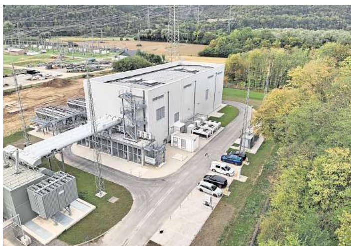
Auf diesem Bild ist ein rotierender Phasenschieber am Tennet-Standort Würigassen zu sehen. Ein entsprechendes Bauwerk wird nun auf dem Areal des Umspannwerks Lübeck-West in Stockelsdorf errichtet. Foto: Tennet
