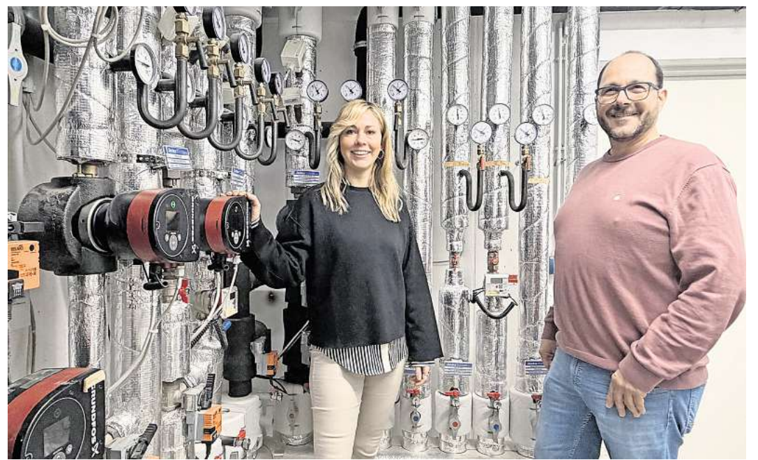
Stockelsdorfs neue Energiemanagerin Luise Stöhrmann schaut sich mit Bauamtsleiter Jan-Christian Ohm eine Heizungsanlage an.
